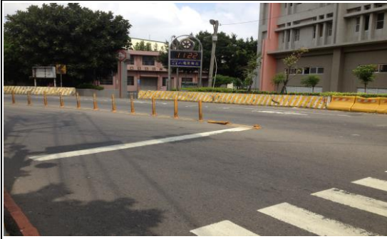
改善前： 回覆式安全桿損壞
