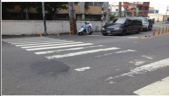
改善前： 斑馬線標線脫落不明
