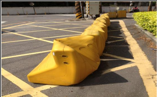
改善前： 紐澤西護欄損壞。
